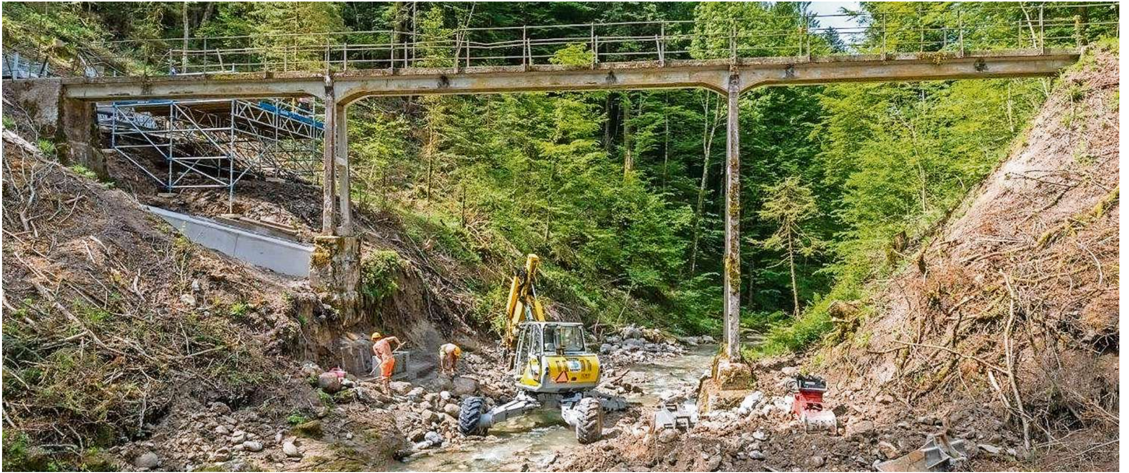
Wacklig auf den Beinen: Zu Beginn der Sanierungsarbeiten wirkt die Hebeltobelbrücke wenig vertrauenswürdig.
