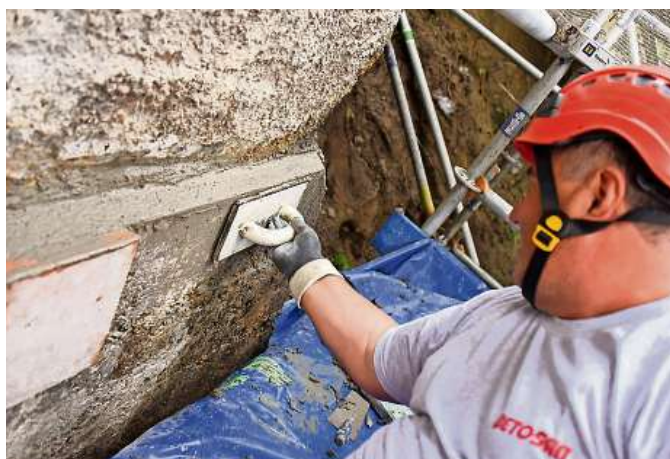
Der letzte Schliff: Ein Mitarbeiter der Betosan bessert das Widerlager am Rand der Brücke mit Mörtel aus.
